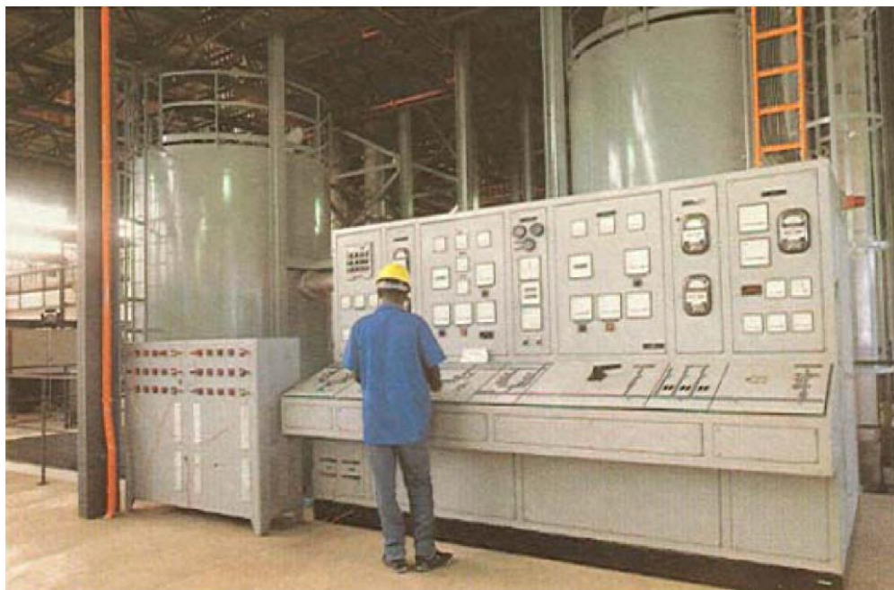
Painel de Controle do LHDC
